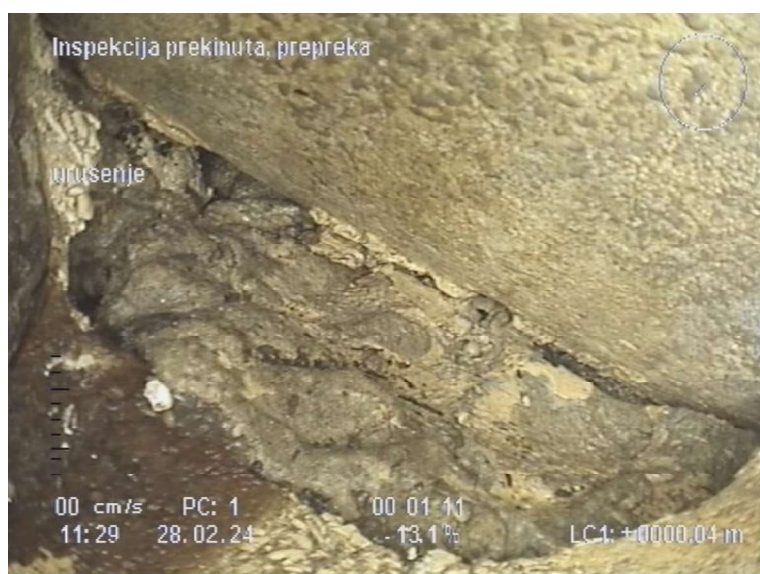
Slika 1. Urušenje u kolektoru
