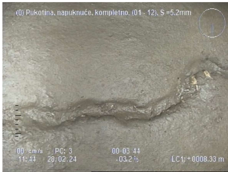
Slika 3. Uzdužna pukotina u cijevi kolektora
