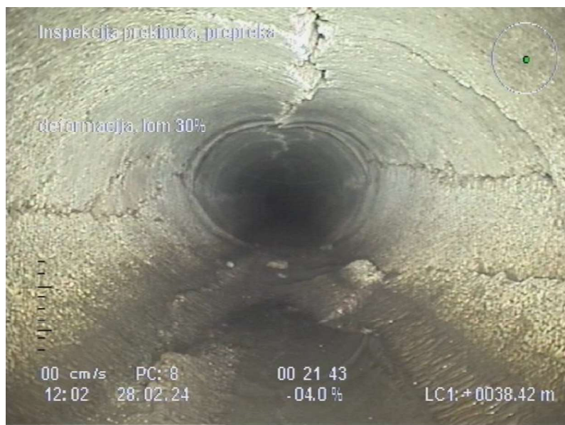
Slika 7. Deformacija cijevi kolektora
