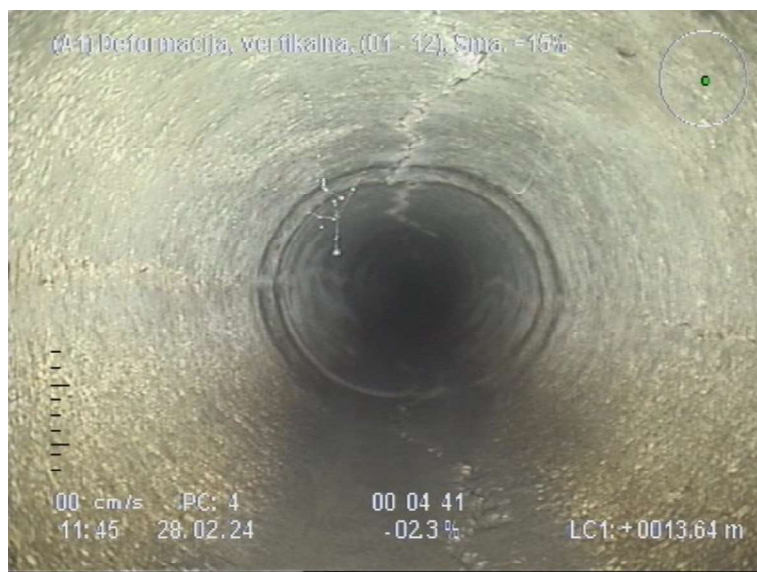
Slika 4. Deformacija cijevi kolektora
