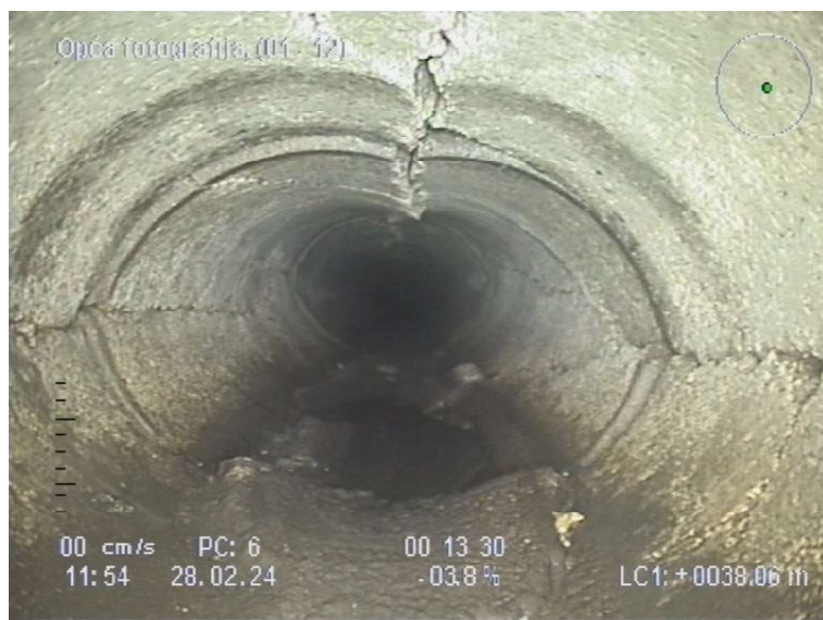
Slika 6. Deformacija cijevi kolektora
